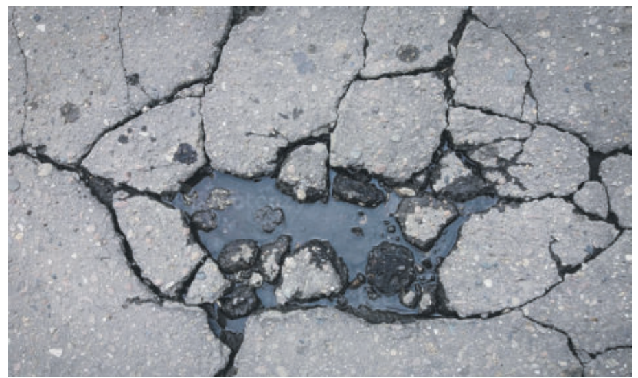
Solche oder ähnliche Schäden kann Wasser auf Asphalt ausrichten. Die müssen dann später repariert werden.
